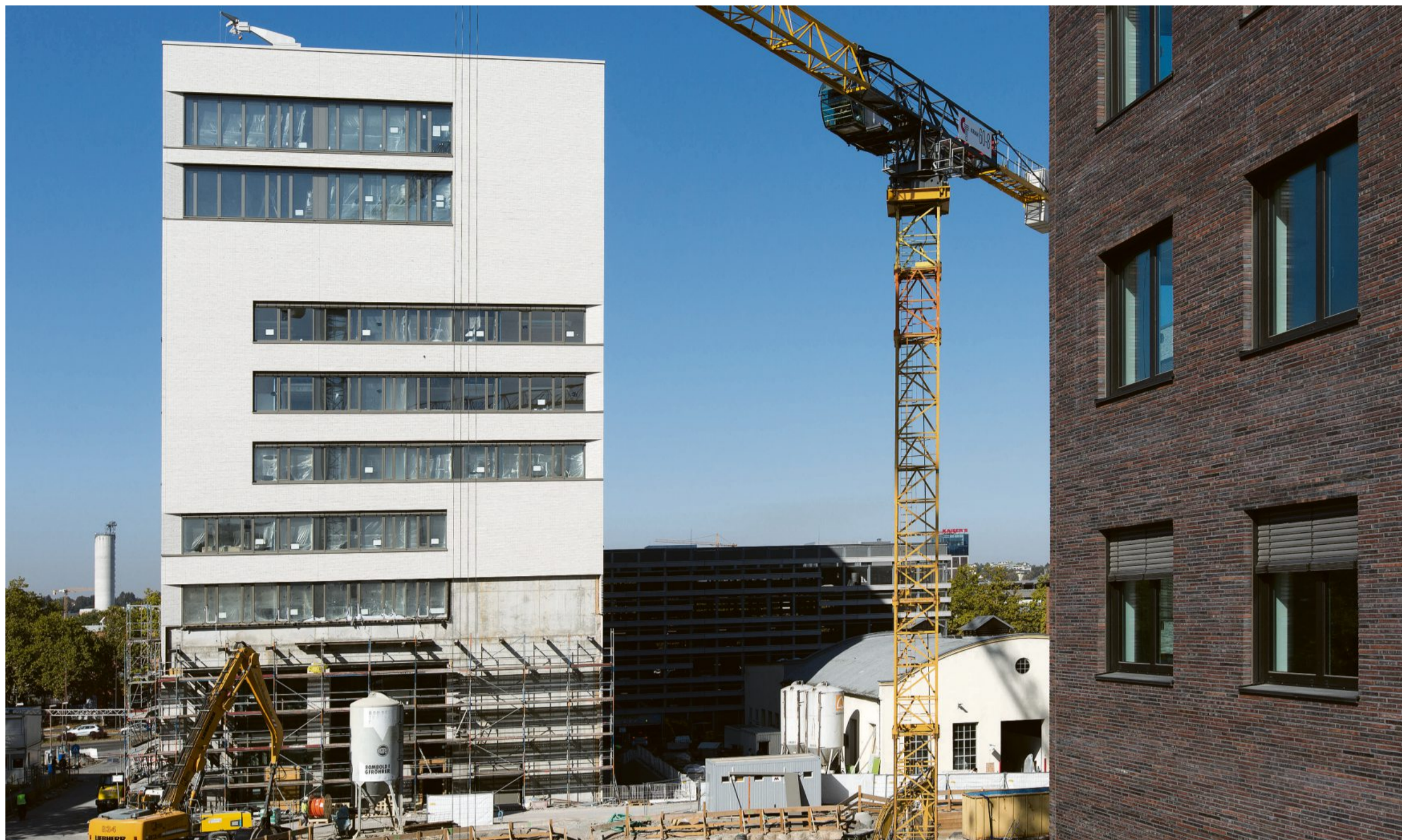
TU München, Außenstelle Heilbronn: In diesen Turm auf dem „Bildungscampus“ der Dieter-Schwarz-Stiftung soll die neue Fakultät einziehen.
